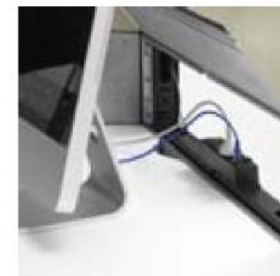
Zasilnie, linia telefoniczna, sieć komputerowa
